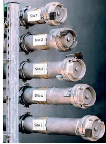
Silo Doldurma ve Tranfer Hatları
