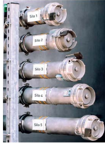
Silo Doldurma ve Tranfer Hatları
