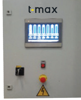
Silo Seviye Kontrolü ve İzlenebilir Dokunmatik Paneller
