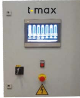
Silo Seviye Kontrolü ve İzlenebilir Dokunmatik Paneller
