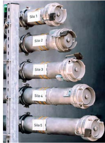
Silo Doldurma ve Tranfer Hatları
